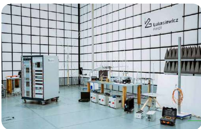
Stano­wisko do badań kom­patybil­ności elek­tro­magne­tycznej – komora EMC
